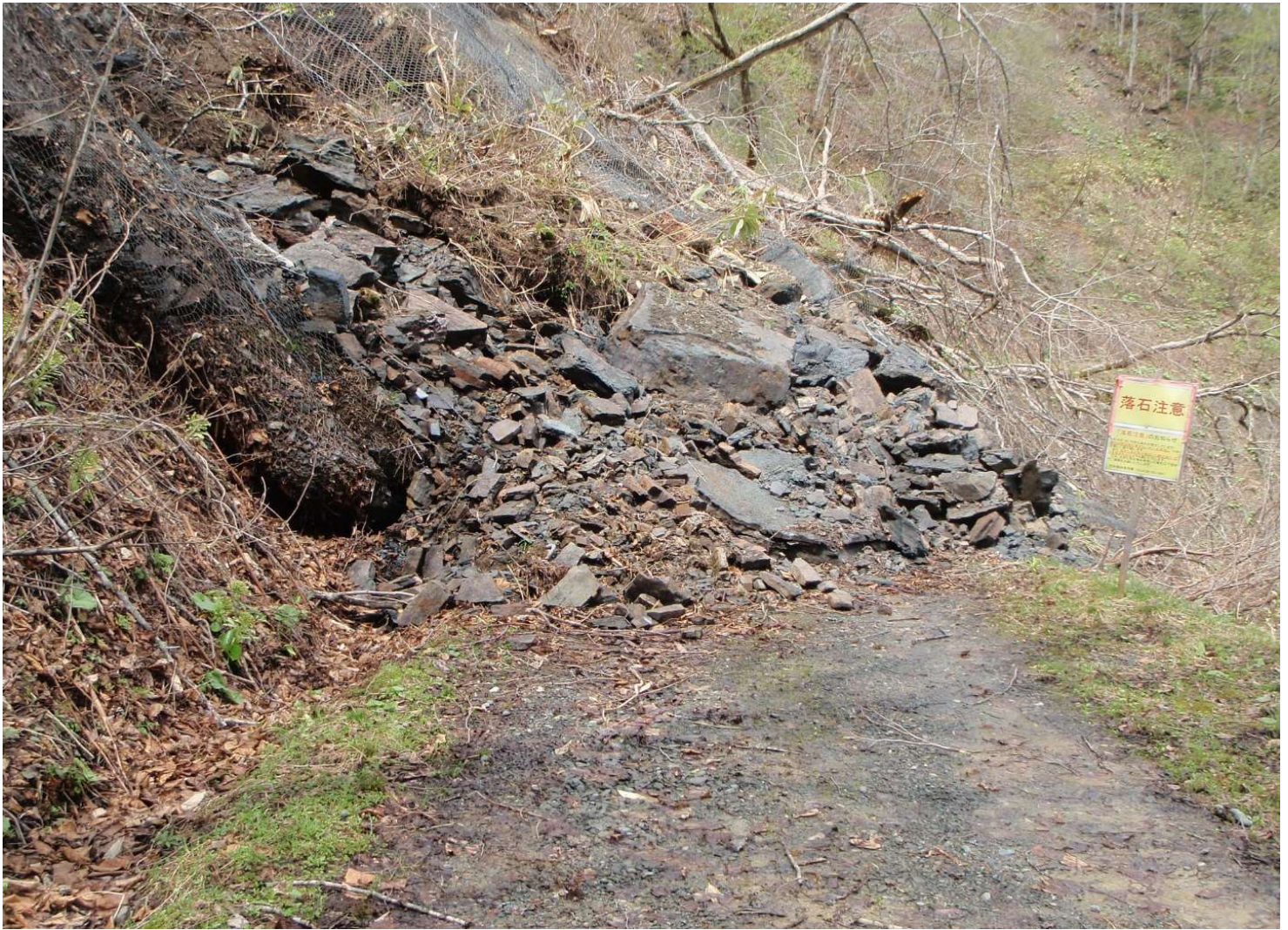
◇鹿島林道2.4km地点崩落箇所（林道上）
