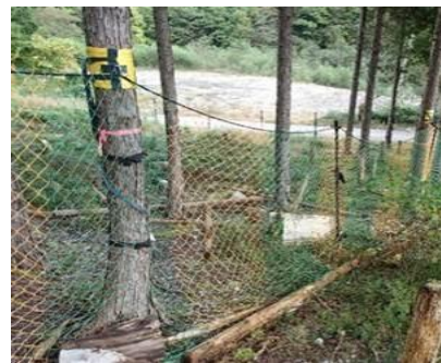
低コスト化を図るため 立木を利用した防護柵 (東濃署)
