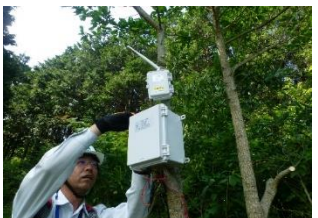
中継器の設置
