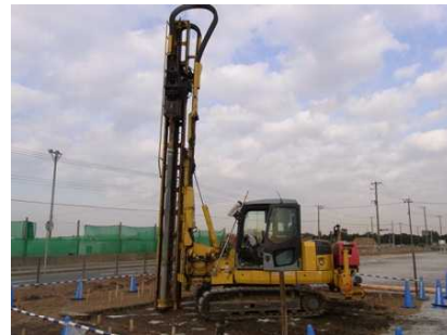
東日本大震災で液状化被害を受けた箇所での地盤改良実証実験状況
