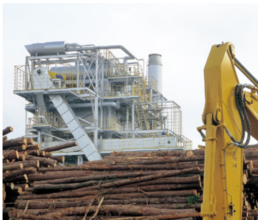
供給された原木と発電ボイラー
