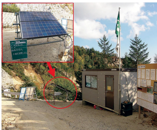
導入した太陽光発電システム
