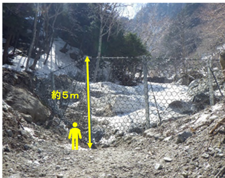
応急復旧対策として強靱ワイヤーネットを設置(上高地、地上高は約5m)
