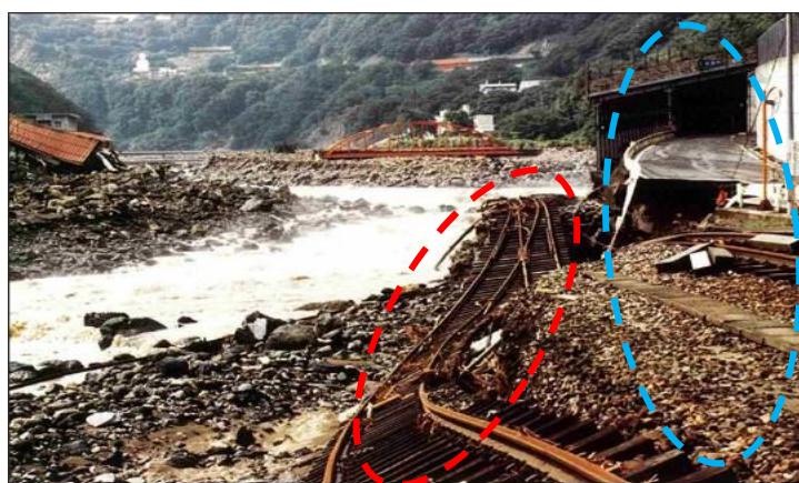
姫川の氾濫により寸断された国道 148 号と JR 大系線
