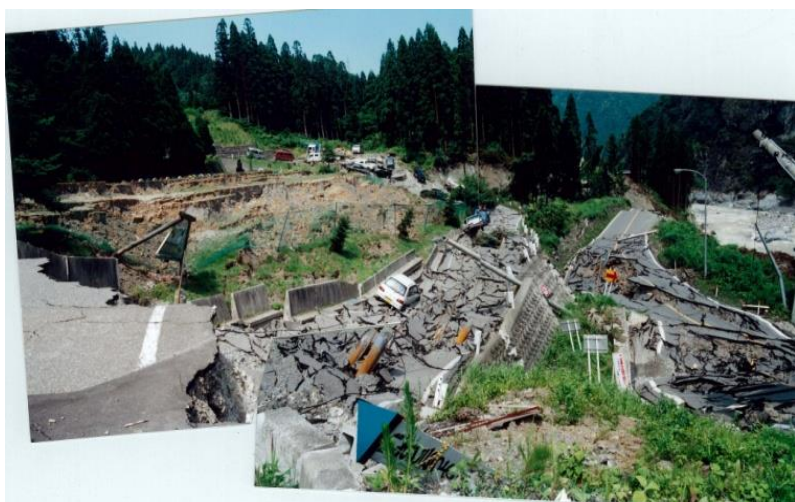
地すべりの発生による道路の損壊状況（糸魚川市山之坊地区）
