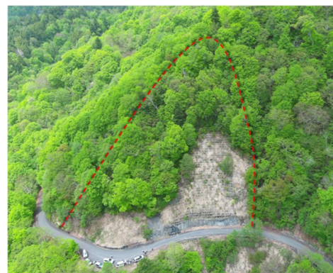
林道の上部で地すべり(赤点線部分)を確認
