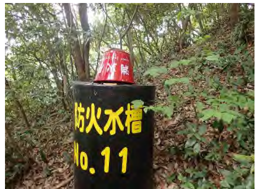
登山道沿線に設置された防火水槽(岐阜署)
