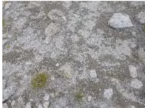
マットを敷設しても 植生が回復しない基質
