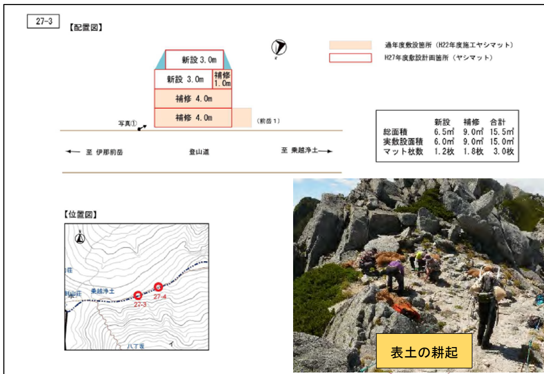
図 3.15 27-3 の補修箇所 (平成 27 年度報告書より抜粋)
