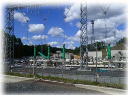
変電送電設備用地敷 (上小鳥国有林)
