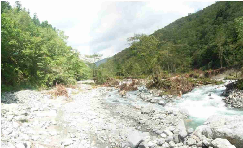
写真-1 海ノ溝谷流域の荒廃状況
