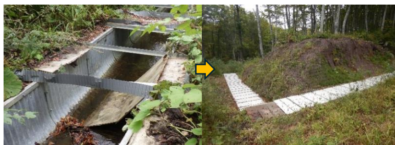
(写真8：損傷状況 及び 置換状況(水路の一部区間))
