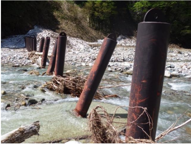
(写真7：捕捉工の破損状況)
