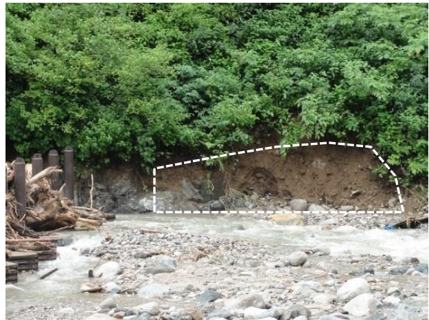
(写真3：左岸側の溪岸侵食)
