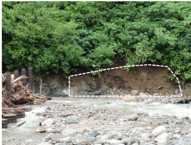
(写真3：左岸側の溪岸侵食)
