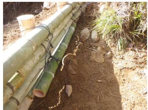
(写真9：横木間の隙間)
