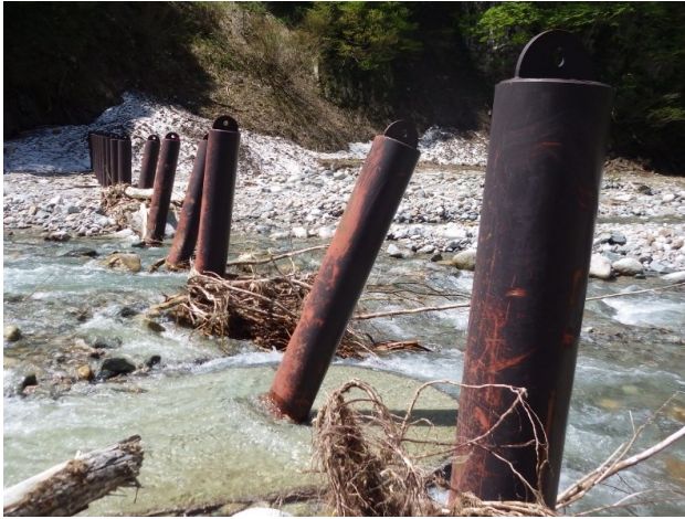
(写真7：捕捉工の破損状況)
