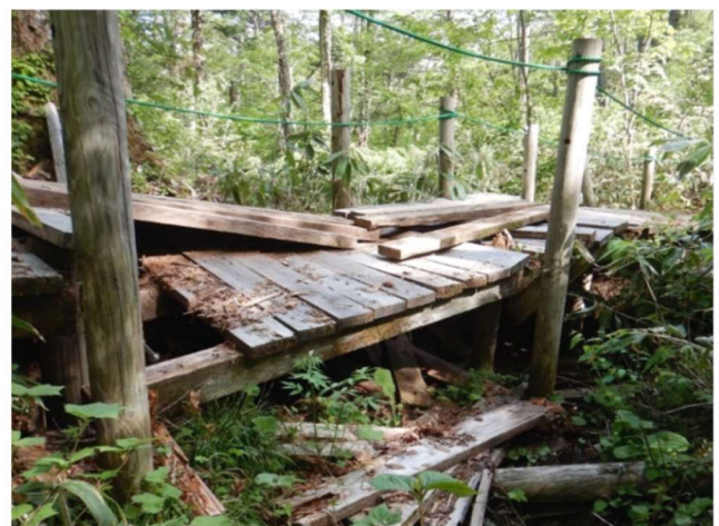
写真－4 落ち込んだ木道
