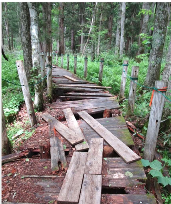
写真－3 全体に傾いた木道
