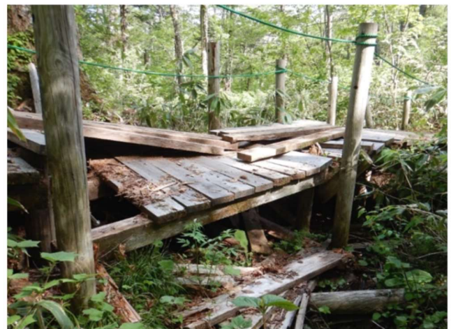
写真－4 落ち込んだ木道
