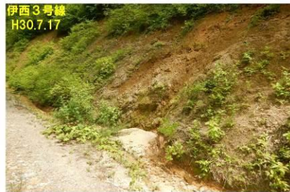
写真-2 被災状況 伊西3号線
