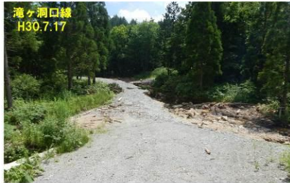
写真-4 被災状況 滝ヶ洞口線
