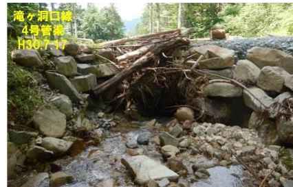
写真-8 被災状況 滝ヶ洞口線
