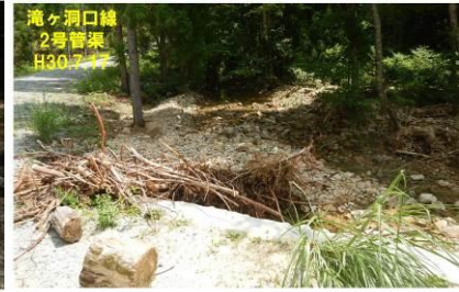
写真-6 被災状況 滝ヶ洞口線
