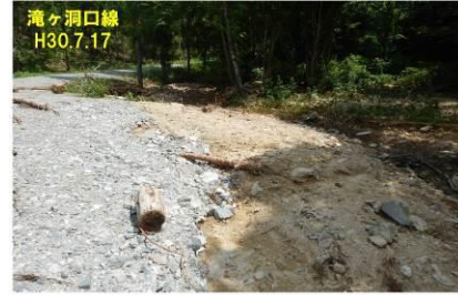
写真-5 被災状況 滝ヶ洞口線
