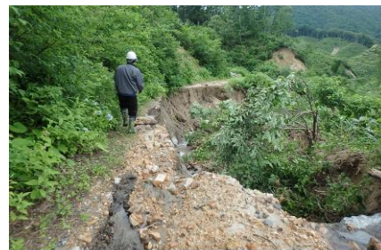
写真-10 被災状況 近隣林道
