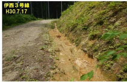
写真-1 被災状況 伊西3号線
