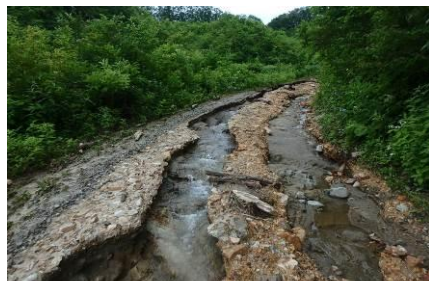
写真-9 被災状況 近隣林道
