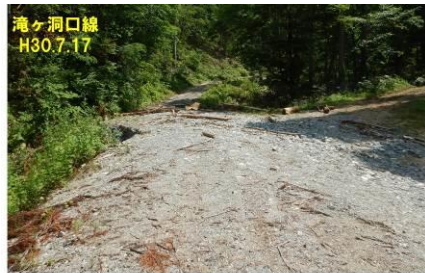
写真-7 被災状況 滝ヶ洞口線
