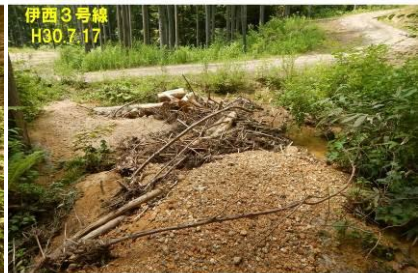
写真-1 被災状況 伊西3号線
