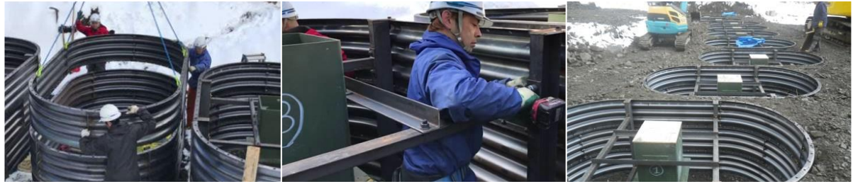
③ライナープレート据付・連結 → ④中間構造（接続部）の組立・設置 → ⑤埋戻し
