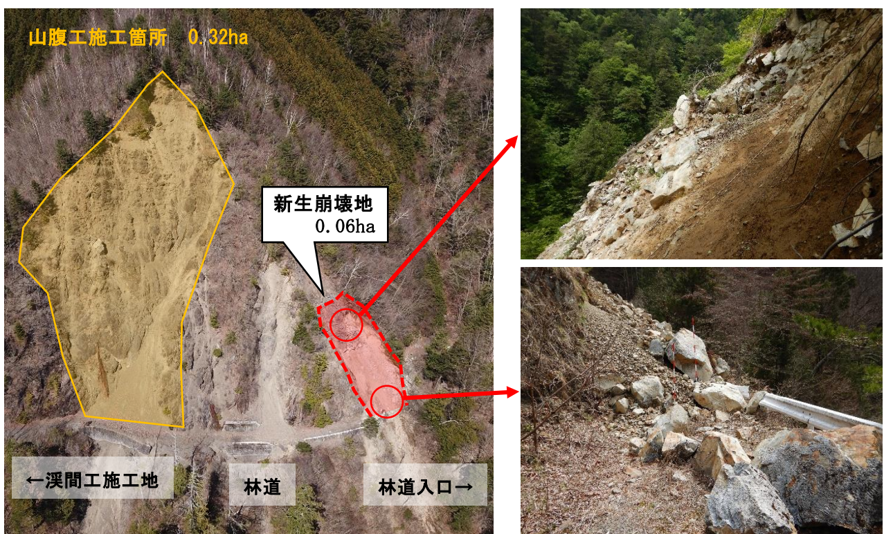
写真－1 崩壊箇所の様子
