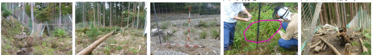
写真13 獣害防護柵の破損原因
