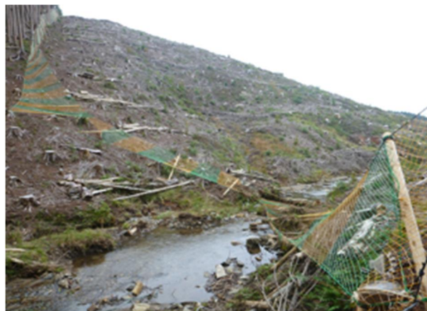
写真-6 平成30年10月 台風被害
