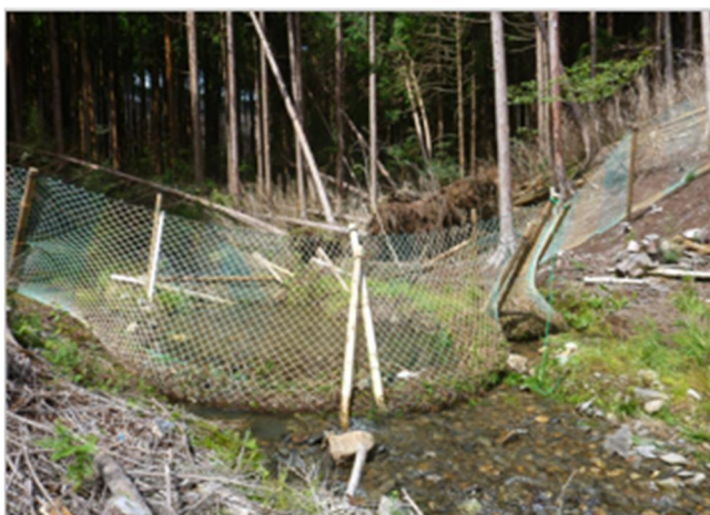
写真－４ 平成 30 年 9 月 台風被害
