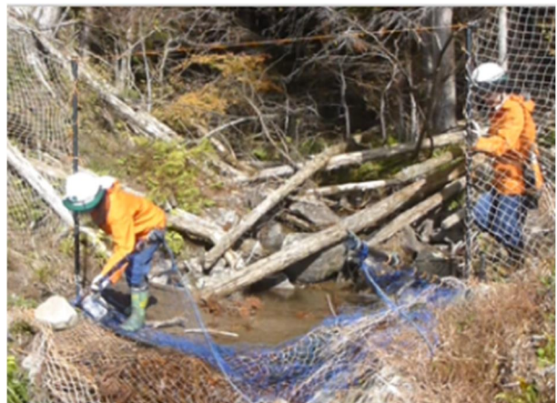
写真－ 9 令和元年 7 月 豪雨被害
