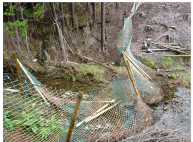
写真－３ 平成 30 年 5 月 大雨被害
