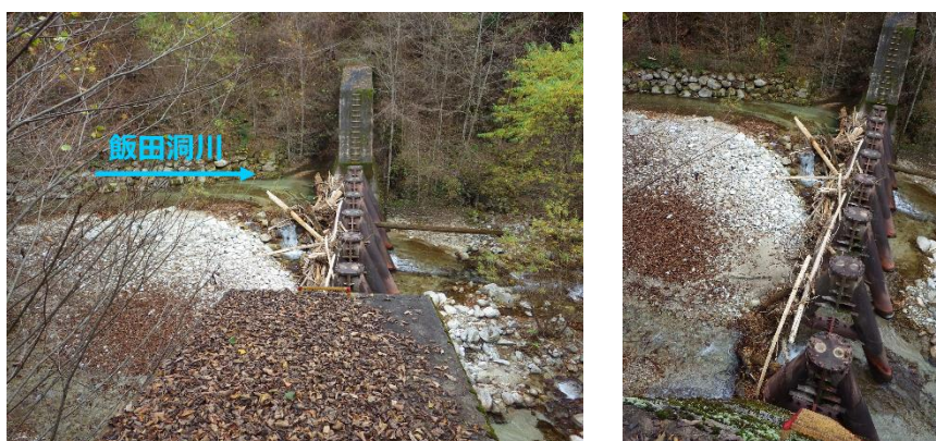
写真-9：流木捕捉状況
