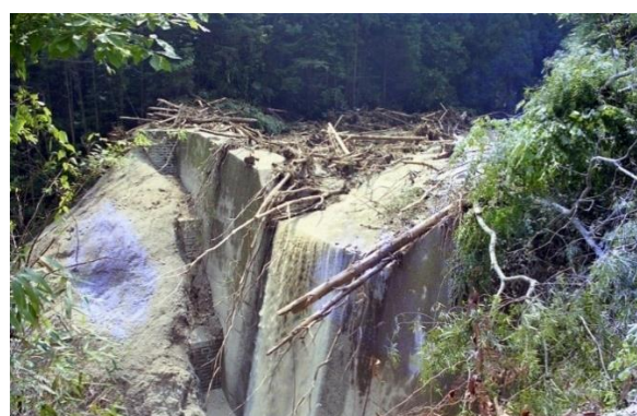
写真-6：災害時の谷止工の状況
