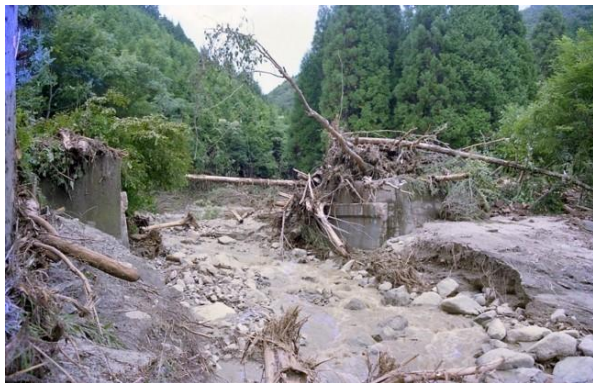
写真-3：橋が流され橋脚のみ残っている状況
