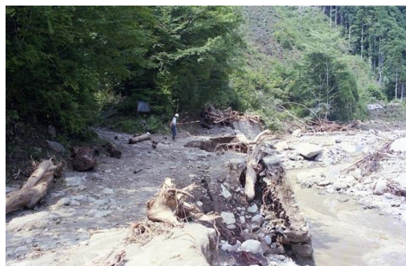
写真-4：林道の被災状況
