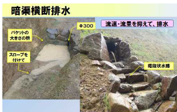
写真-3 降雨時の呑口・はけ口の状況
