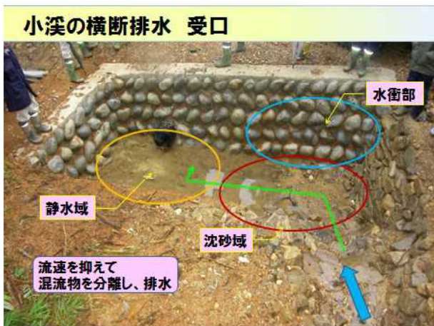
写真-4 小溪の横断排水の水受口 (4) 維持・管理に影響する水受口構造
