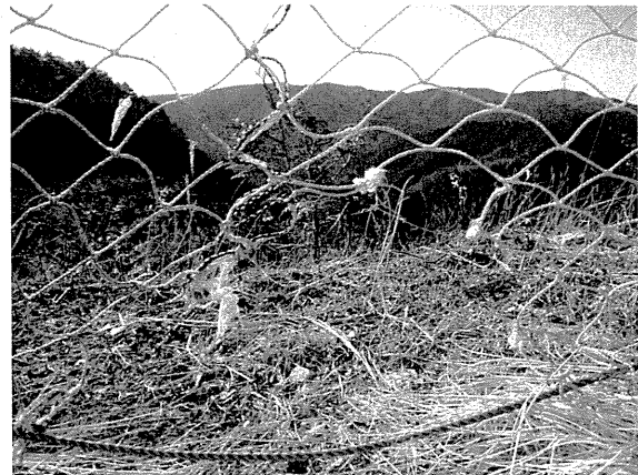
写真10 ネットが破られた跡
