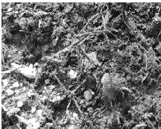
(金網の腐食状況)
