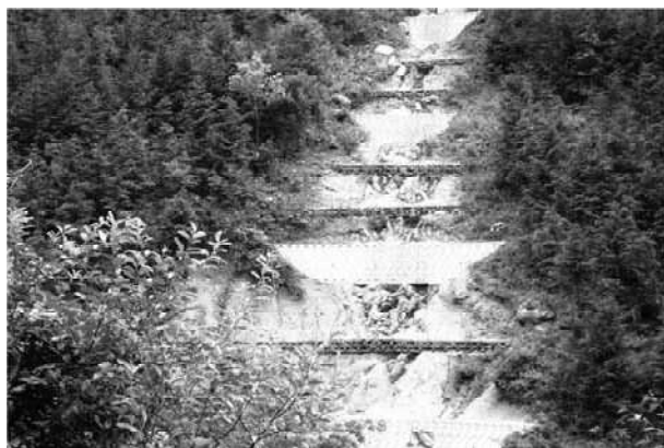
写真－3 雨裂被害
