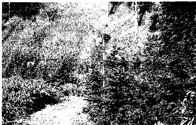
写真-7 林道法面状況図(No. 3)
