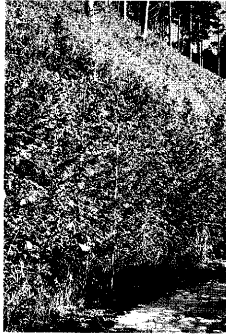
写真-5 林道法面状況図(No. 1)
