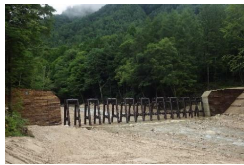
鋼製スリット床固工 (松川村 馬羅尾国有林)
