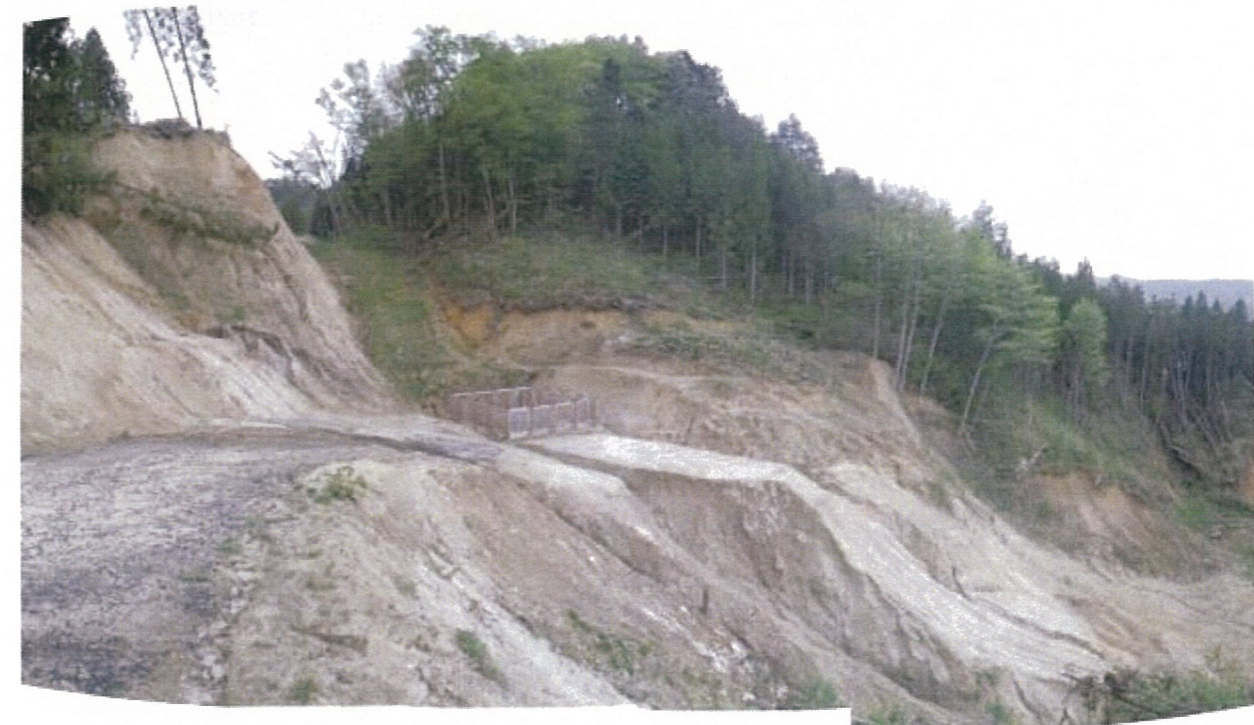
写真 2.5.5 集水井周辺のガリー侵食（平成 24 年 5 月）
