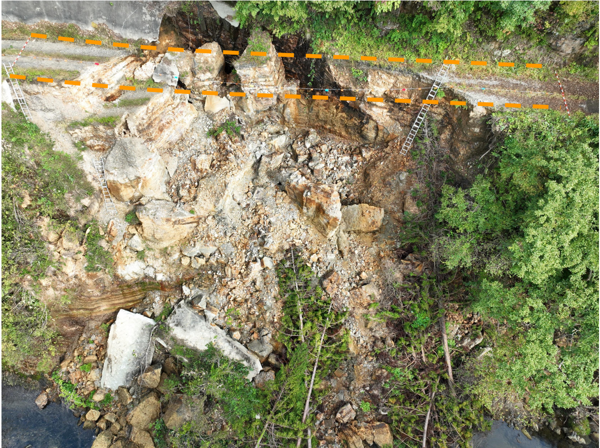
写真1.被災状況（上空から全景）
