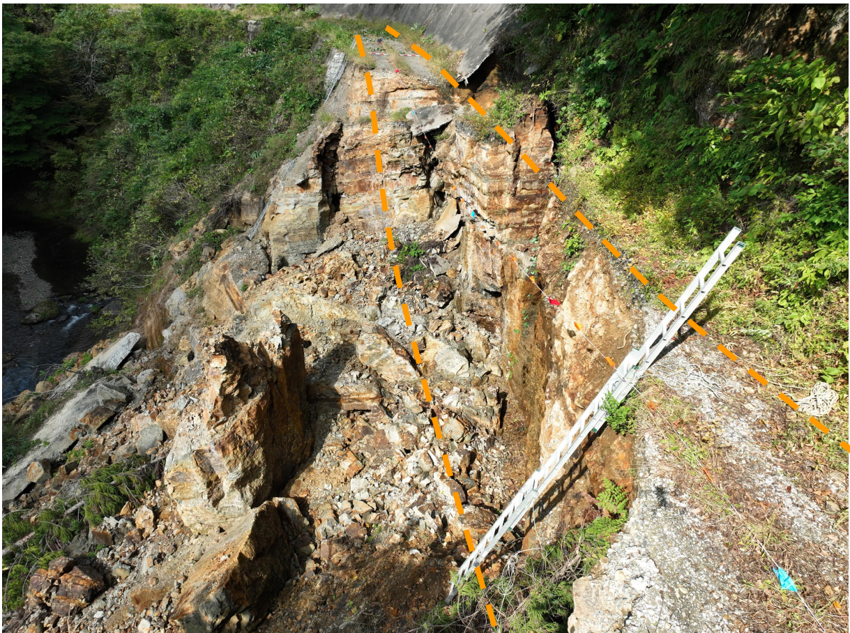
写真2.被災状況（起点側→終点側）
