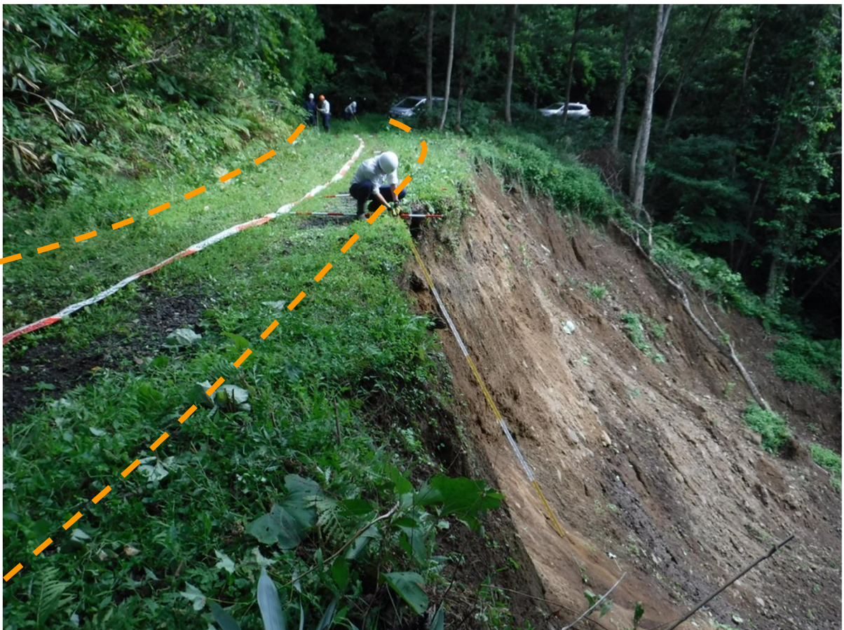
写真2.被災状況（終点側→起点側）
