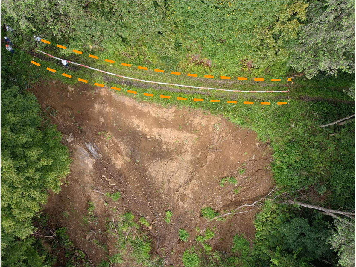
写真1.被災状況（上空から全景）
