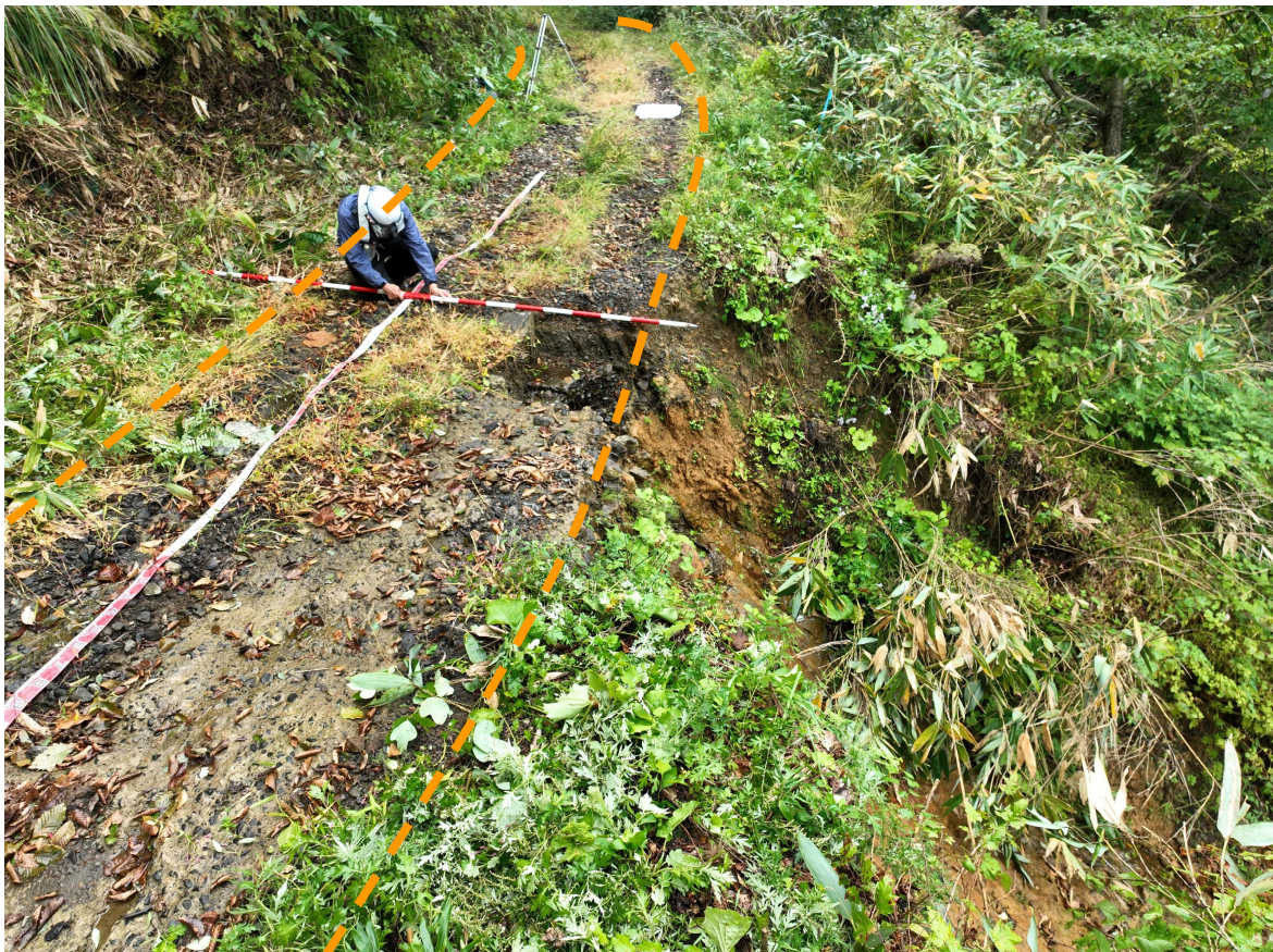
写真 10.被災状況（終点側→起点側：箇所⑤）
