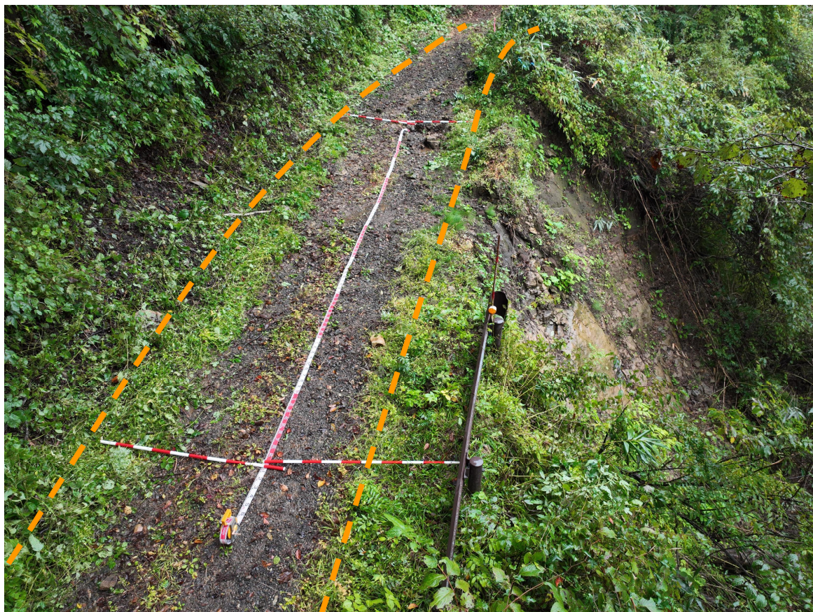
写真4.被災状況（終点側→起点側：箇所②）
