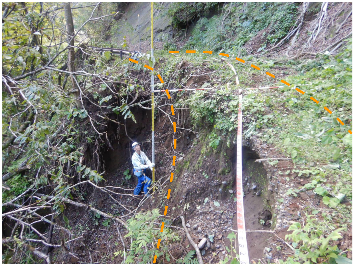
写真2.被災状況（起点側→終点側：箇所①）
