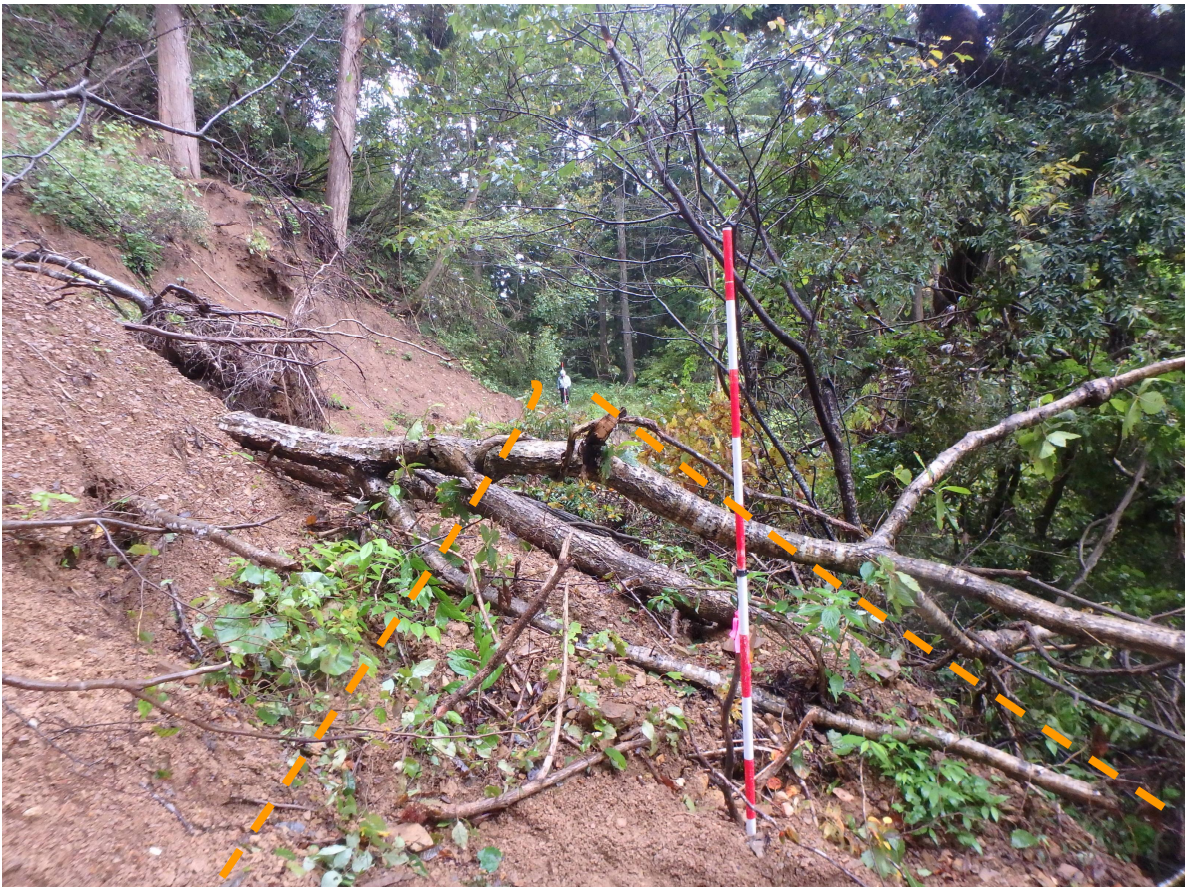
写真2.被災状況（起点側→終点側）
