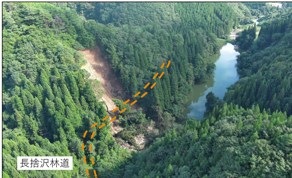
写真1. 崩壊地の状況（全景）
