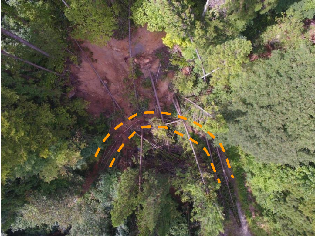
写真18.被災状況（上空から全景：箇所⑨）
