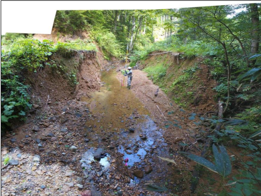
写真 2 1 .被災状況（上流→下流：箇所⑩）
