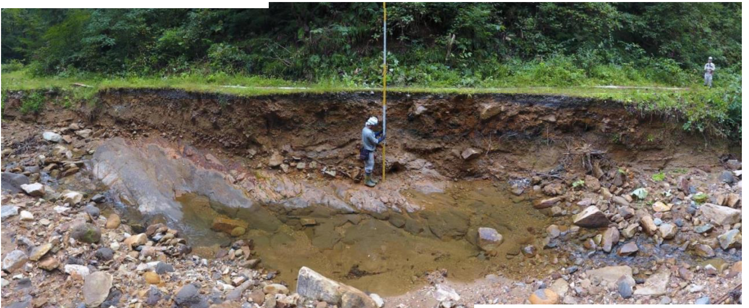
写真11.被災状況（対岸から：箇所⑤）
