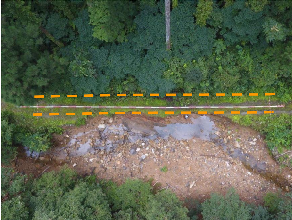
写真10.被災状況（上空から全景：箇所⑤）
