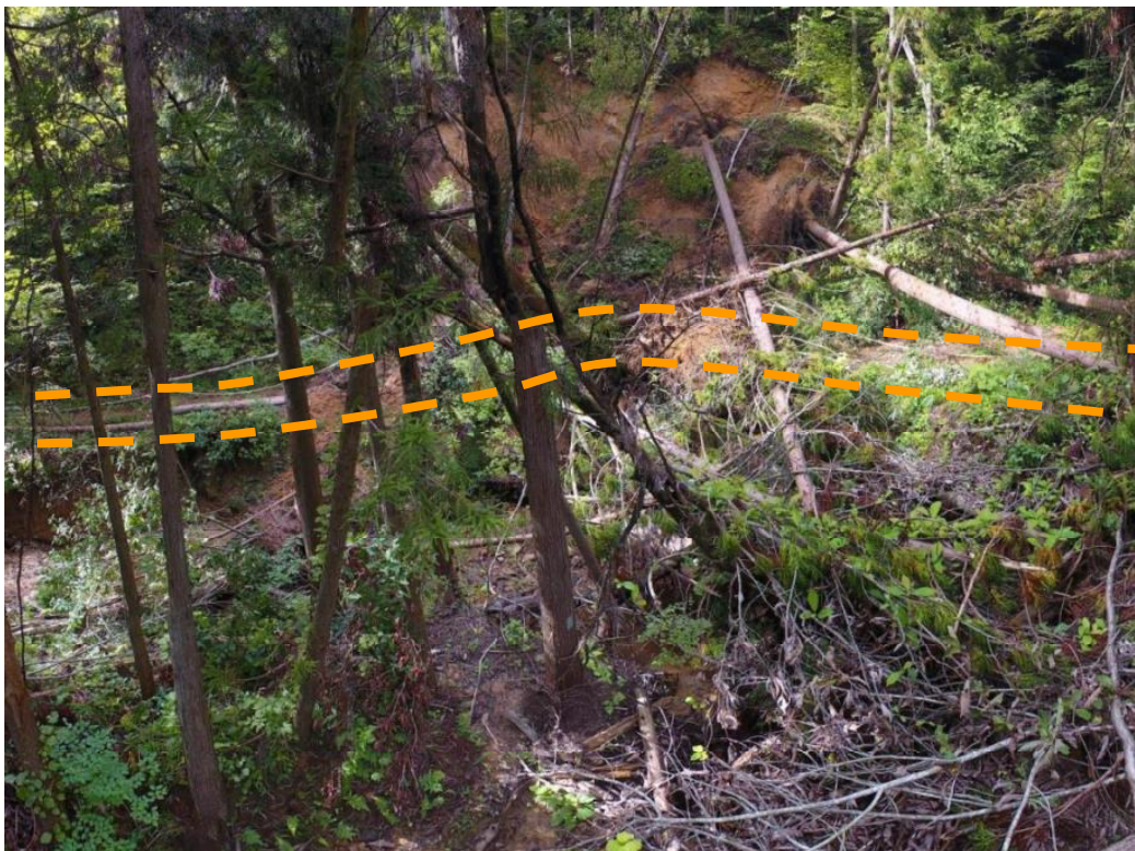
写真19.被災状況（対岸から：箇所⑨）
