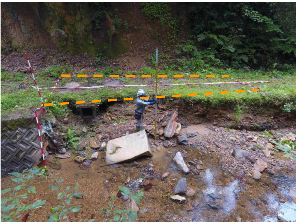
写真 1 3.被災状況（対岸から：箇所⑥）
