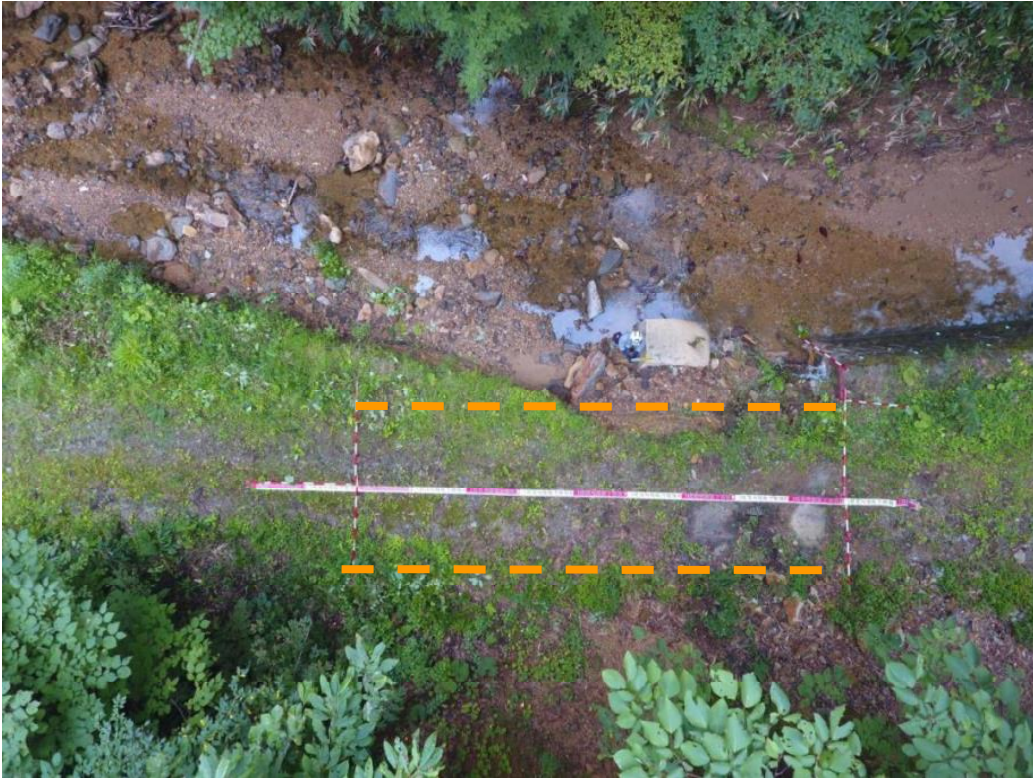
写真 1 2.被災状況（上空から全景：箇所⑥）
