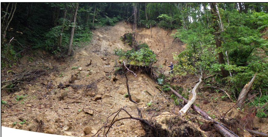
写真9.被災状況（法面崩落状況：箇所④）
