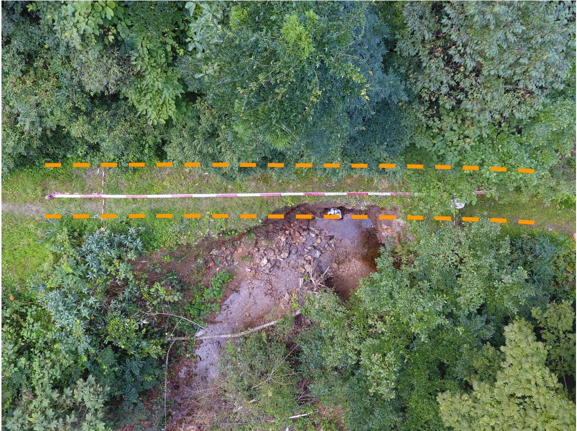
写真5.被災状況（上空から全景：箇所③）
