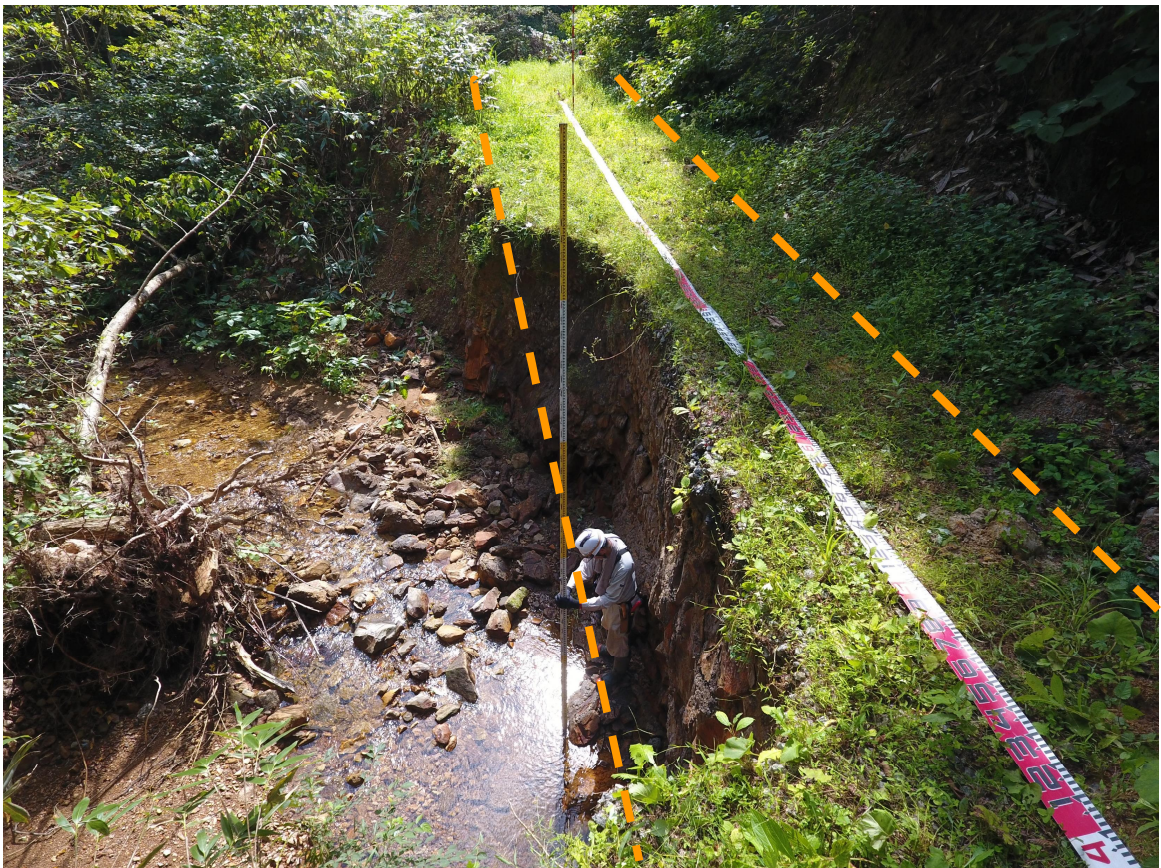
写真6.被災状況（対岸から：箇所③）
