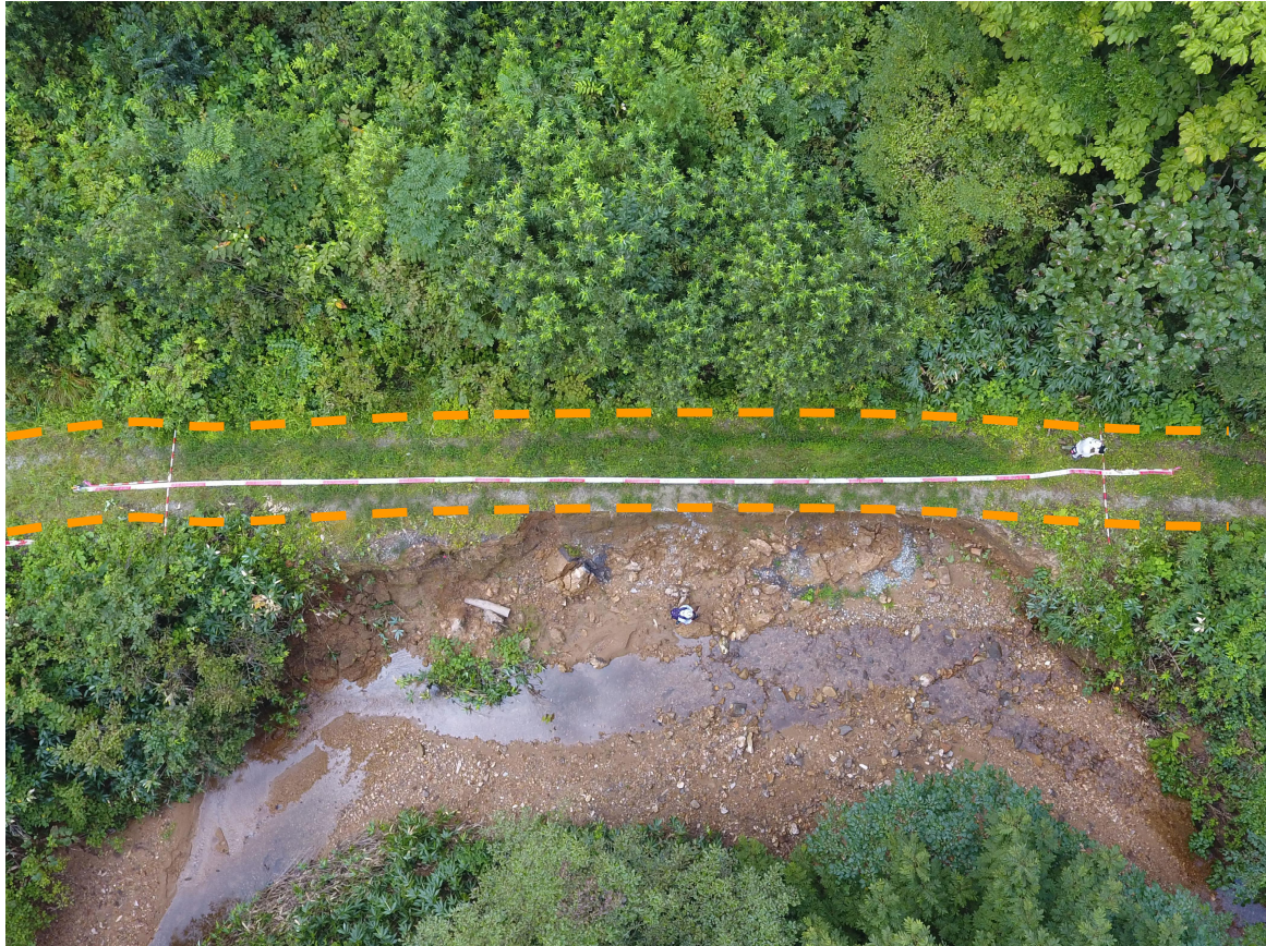
写真3.被災状況（上空から全景：箇所②）
