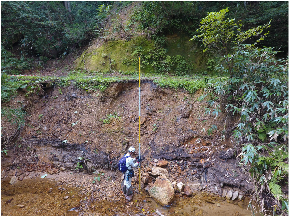
写真2.被災状況（対岸から：箇所①）
