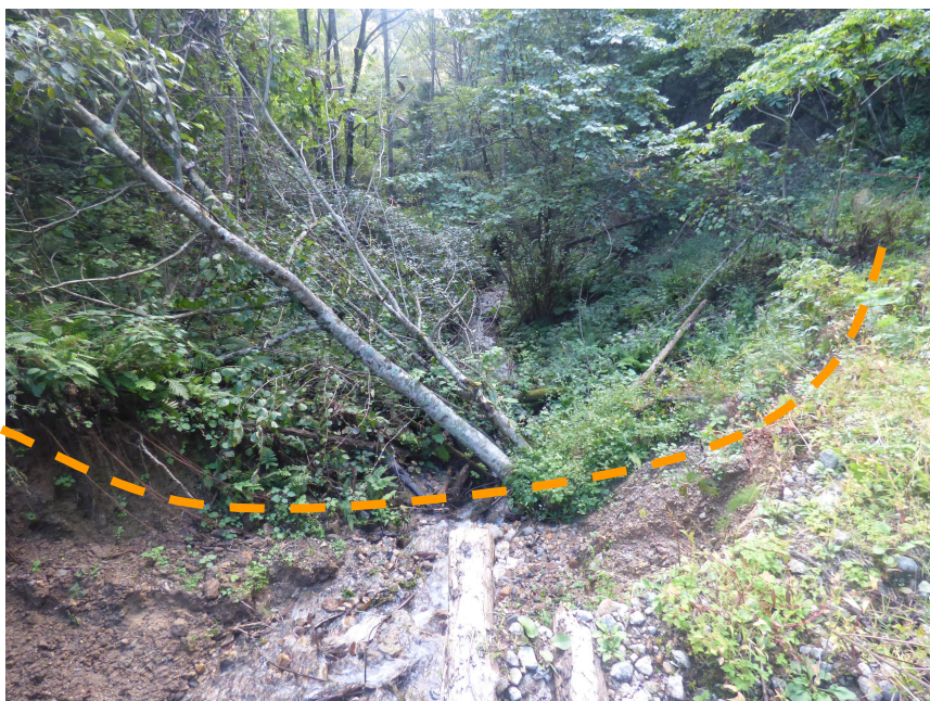
写真3.被災状況（沼ノ沢上流→下流）
