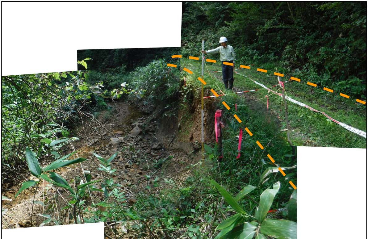
写真4.被災状況（起点側→終点側：箇所②）
