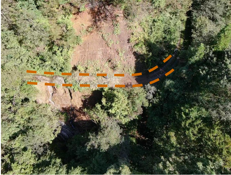
写真 1 .被災状況（全景：箇所①）
