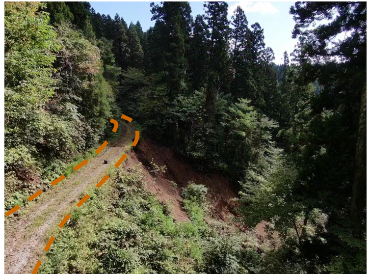
写真 4 .被災状況（起点側→終点側：箇所②）
