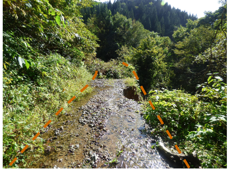
写真 2 .被災状況（起点側→終点側：箇所①）
