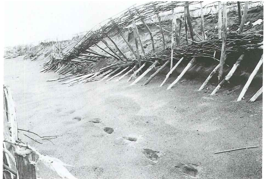
波浪によって破壊された防浪垣。(後谷地 S.32)
