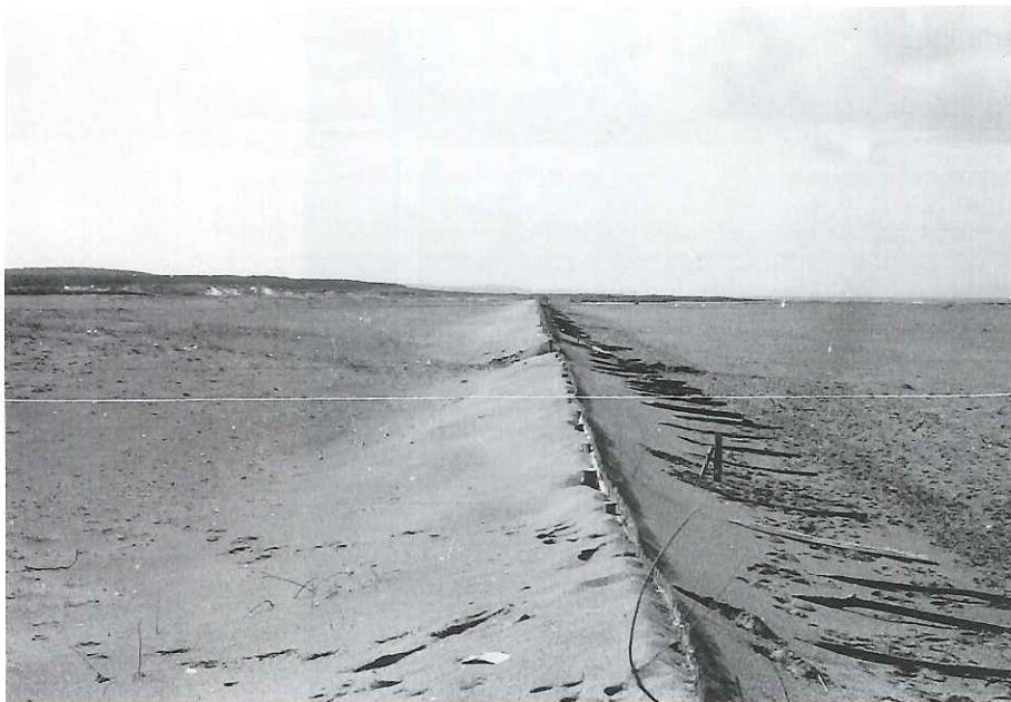
堆砂垣を設けて、その前後に砂を堆積させ、砂丘を造成する。まず、一列目の堆砂垣を造成する。(大開浜)
