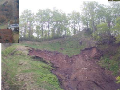
菖蒲沼グレンデ下側斜面の崩壊地
