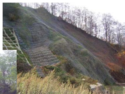
菖蒲沼グレンデ下側斜面の崩壊地対策 平成23年
