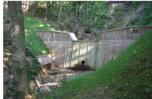
保安施設(谷止工)
