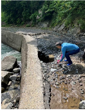
7月20日 赤石川溪流線崩壊場所の巡視 場所：赤石川溪流線
