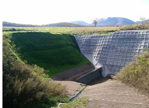
左又沢治山工事(鉄筋挿入工併用法砕工,植生基材吹付工) (十和田市)
