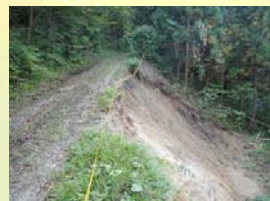
路肩が崩落した林道…
