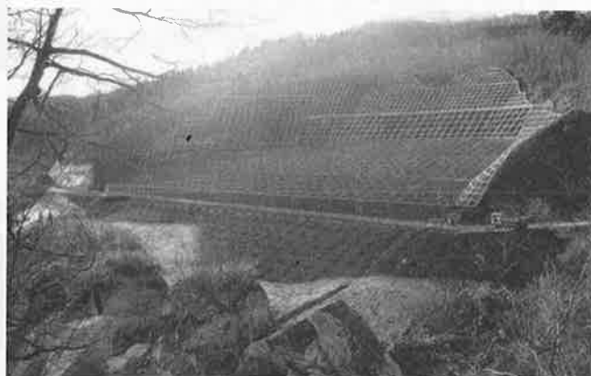
写真-12 市野々原地区地すべり Cブロック山腹工完成
