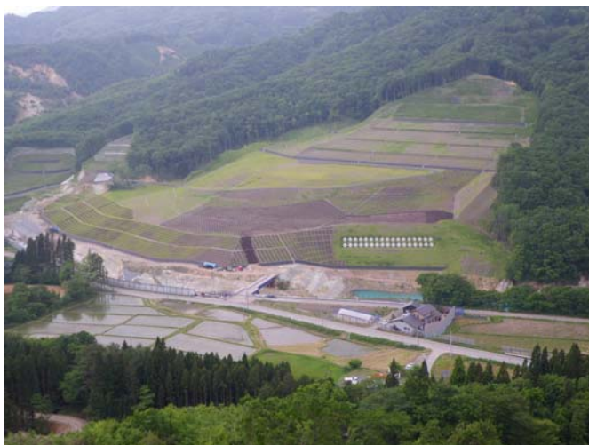
【地すべり災害の復旧（一関市）】
