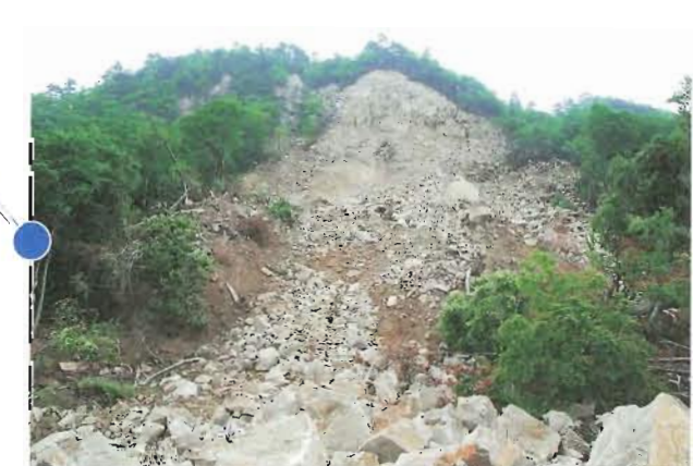
尿前沢中流左岸 山腹崩壊地内の荒廃状況
