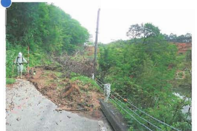
柳沢 山腹崩壊から流出した土砂による県道被災状況
