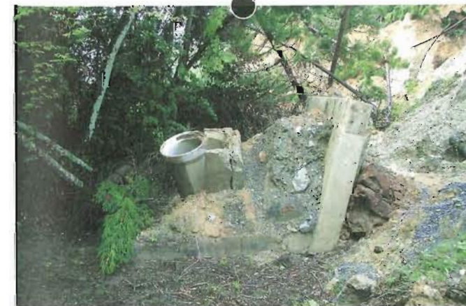
地すべり末端部付近の擾乱帯で隆起したヒューム管と破碎シルト岩
