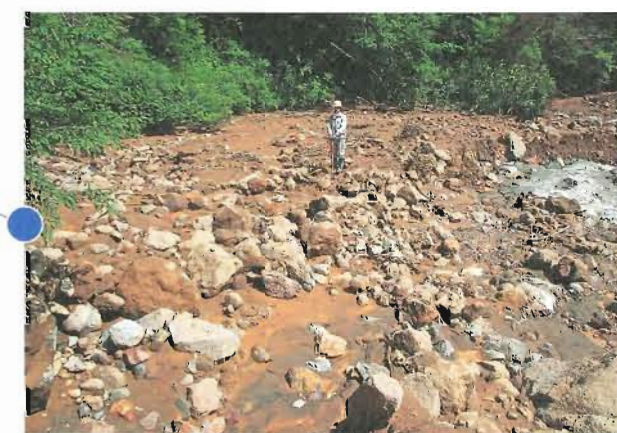
産女川上流 溪流荒廃状況
