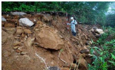
冠頭部滑落崖上方斜面の拡大亀裂
